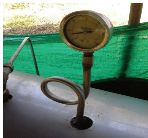
Imagen 10. Elementos de la planta sin mantenimiento - Elements of the plant without maintenance
