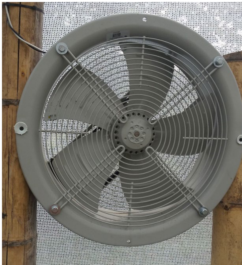
Figura 11. Extractor de aire. Fuente: Autores.
