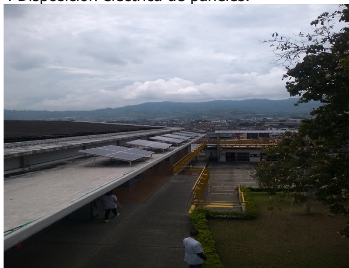
Figura 3. 24 Paneles solares fotovoltaicos de 255W cada uno, instalados sobre techo CDITI. Fuente: Autor
