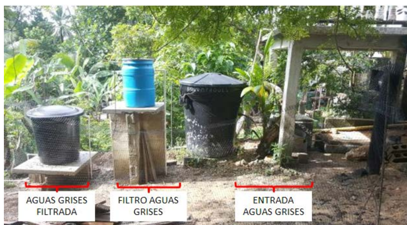
Figura 3. Sistema de filtro implementado para tratamiento de aguas grises
