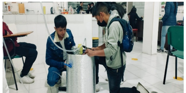
Figura 4. Enchaquetamiento de biodigester con aislante térmico de 5mm de espesor.
