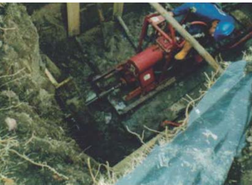
Imagen 3. Operación de equipo de excavación sin Zanja Fuente: foto suministrada por William Montaña
