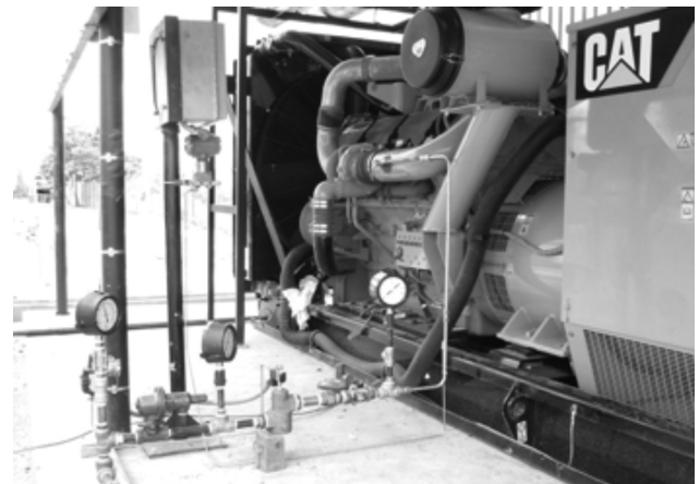
Figura 4. Fotografía del grupo electrógeno utilizado
