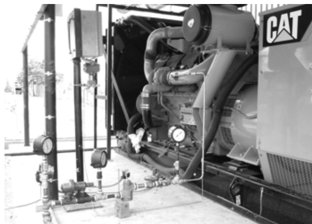
Figura 4. Fotografía del grupo electrógeno utilizado
