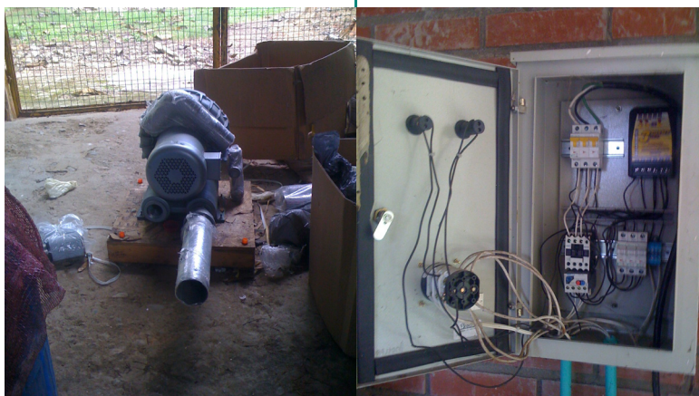
Fig. 3 Aireador Blower de 10 HP con respectivo sistema de arranque y protección.
