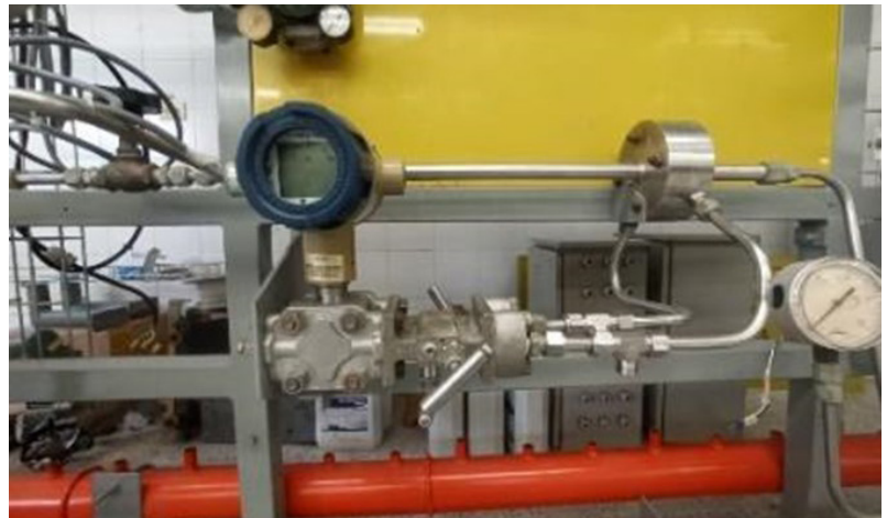
Figura2.Fotografía tomada en el ambiente instrumentación CIDT-Barrancabermeja.
