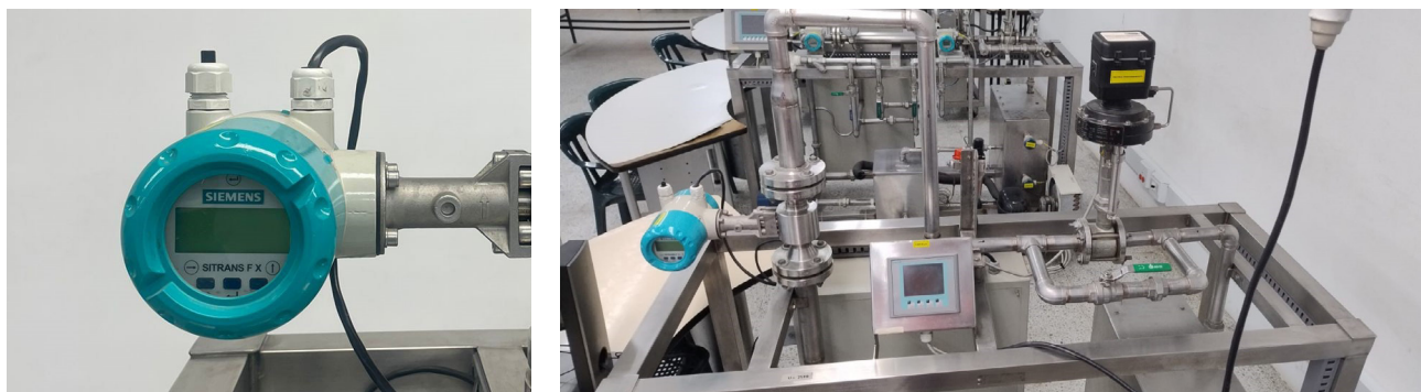
Figura 4. Fotografía tomada en el ambiente instrumentación CIDT-Barrancabermeja.
