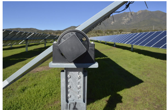
Figura 6: grupo de paneles solares con sistema de seguimiento
