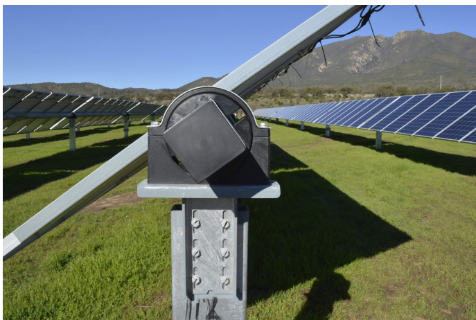
Figura 6: grupo de paneles solares con sistema de seguimiento
