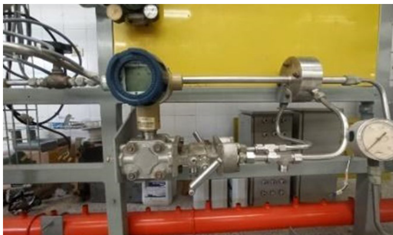
Figura2.Fotografía tomada en el ambiente instrumentación CIDT-Barrancabermeja.
