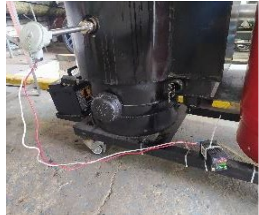
Foto 3. Sistema de registro de temperatura en reactor
