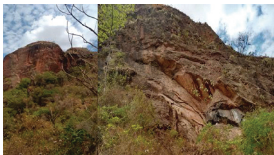
Figura 11. Zona degradada estación 8
