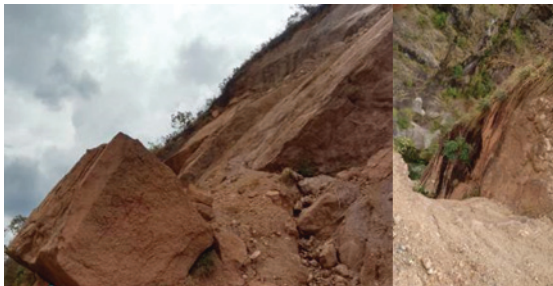
Figura 15. Zona degradada estación 12
