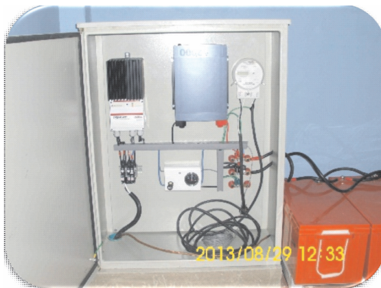
Figura 4. Dispositivos instalados en el panel de control. Fuente: Elaboración propia (2014).
