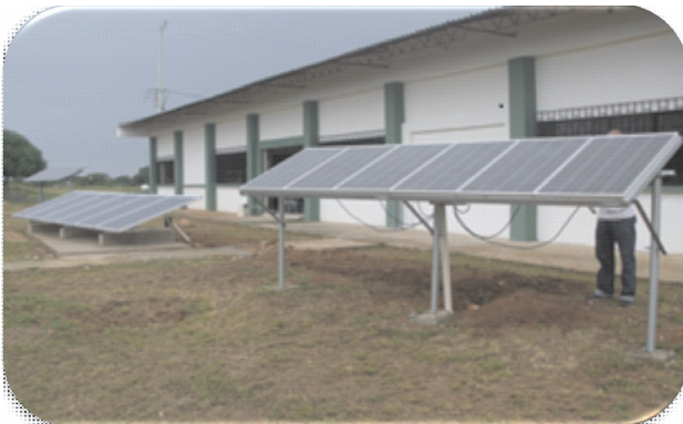
Figura 2. Paneles solares fotovoltaicos.
