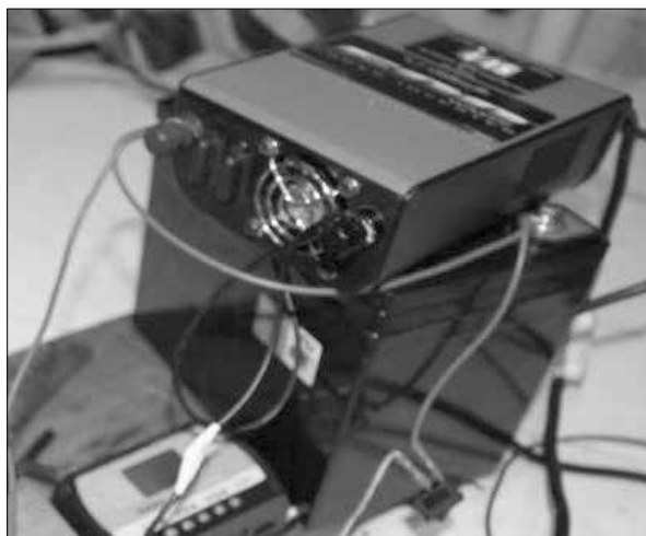
Figura 3. Batería, inversor y regulador del proyecto. Fuente: Elaboración propia.
