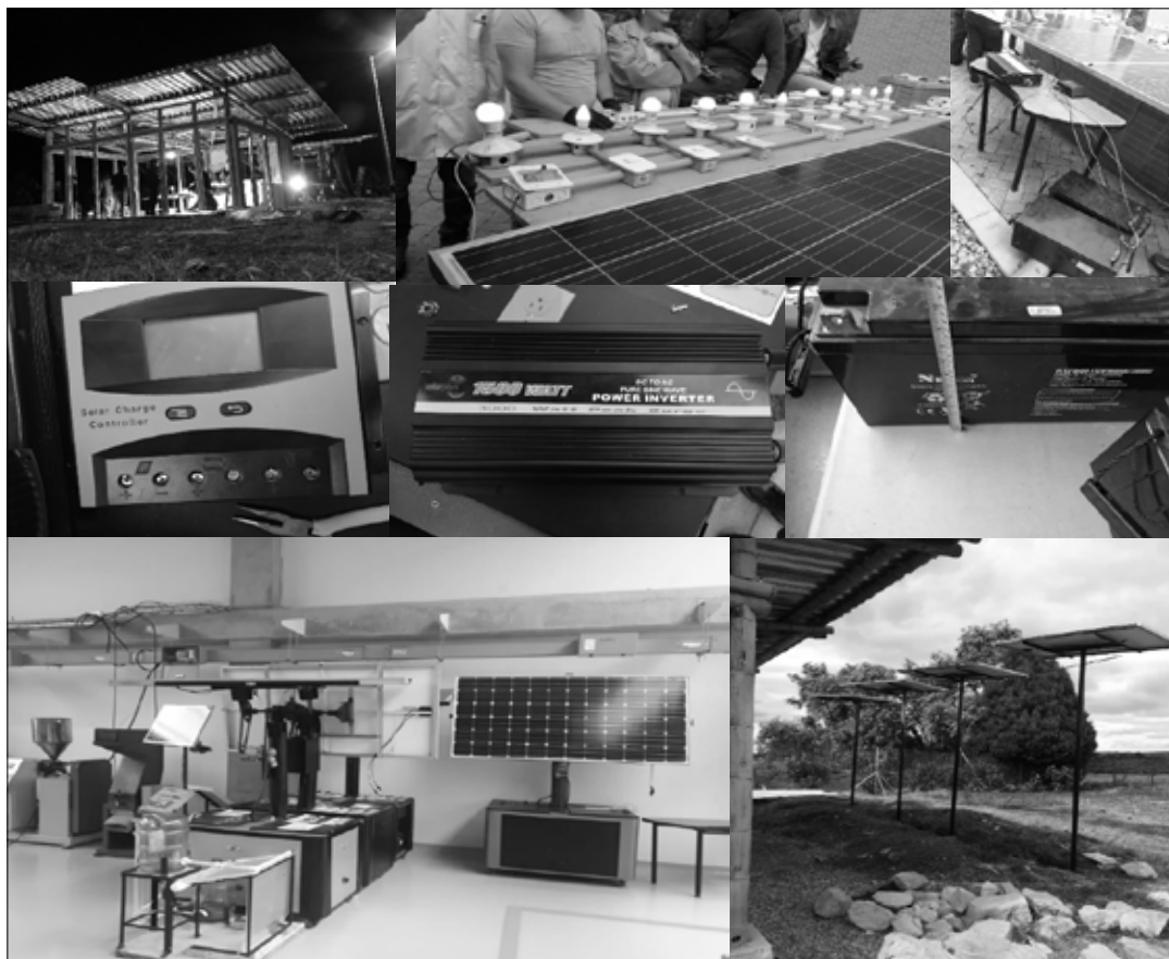
Figura 7. Red Eléctrica y Sistema Fotovoltaico Vivienda ECO Sostenible. Fuente: Elaborado Grupo de Investigación GITAE ECOVIVIENDA, Chía Cundinamarca.
