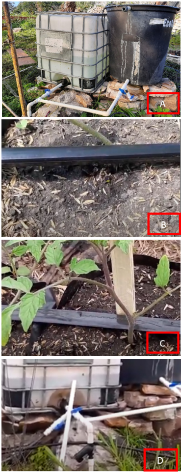
Figura 5. Instalación sistema de fertirriego. A. Tanques de 1000 y 500 litros. B y C. Cintas por goteo. D. Cabezal de riego (Llaves de paso y unidad de filtrado).
